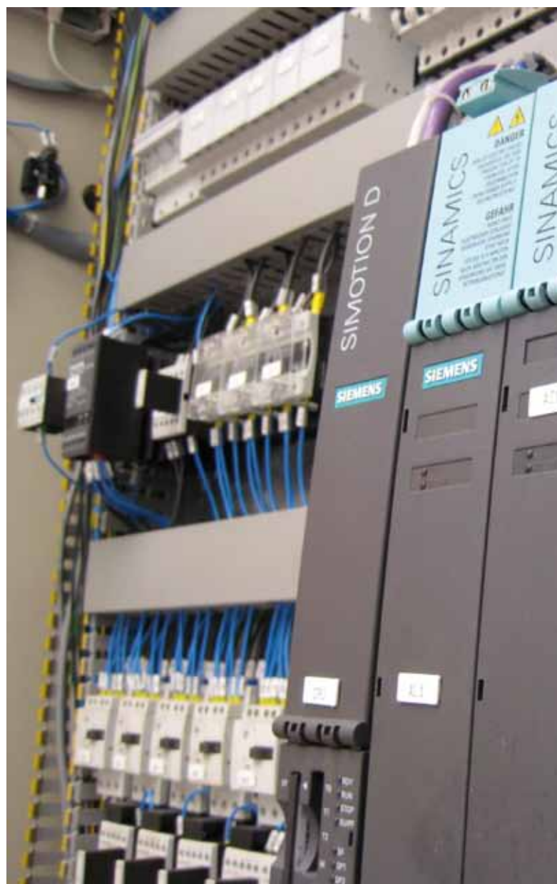
L'elettronica fornisce un sostanziale contributo anche alla sicurezza
